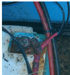
Deficiencia: batería en mal estado
