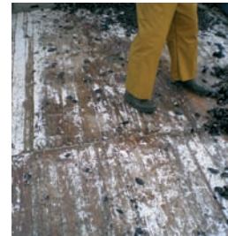
Deficiencia: chan da cuberta sen pintar e escorregadizo polos restos de mexillóns
