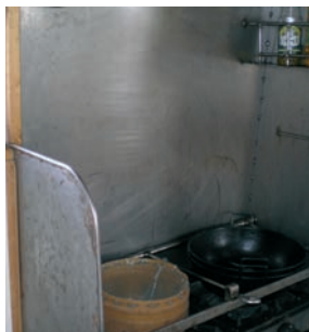
Deficiencia: cociña en malas condicións
