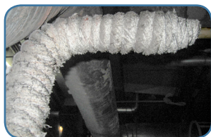
Corda trenzada (calorifugado)
