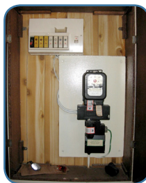
Panel illante detrás do contador
