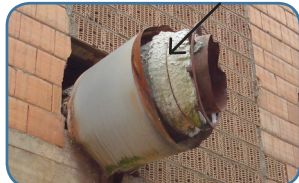
Calorifugado en conduto de evacuación de fumes industriais
