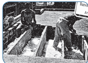
Amianto solto en cámara de cuberta 1
