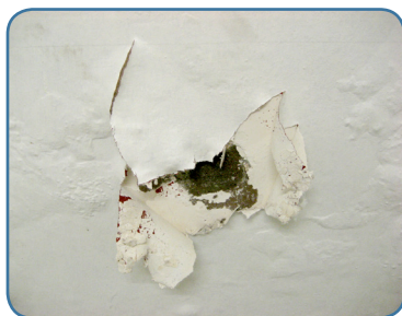
Pintura con amianto
