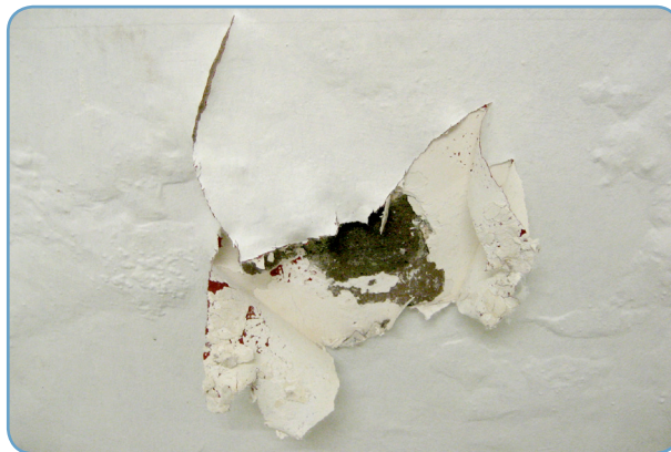
Pintura con amianto
