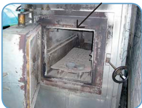
Cordón de amianto sellando la puerta 2
