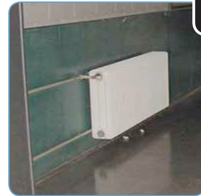
En pavimento y zócalo 1
