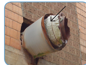
Calorifugado en conducto de evacuación de humos industriales
