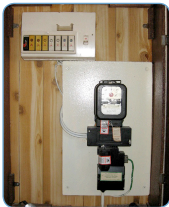
Panel aislante detrás del contador
