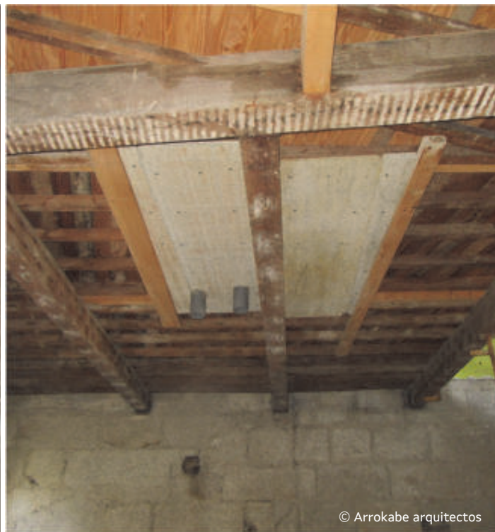
Alteraciones en estructura
